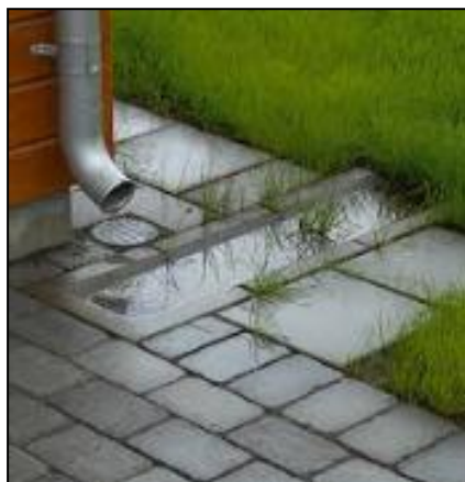
Figur 18 Rännaldal som leder takvatten.
